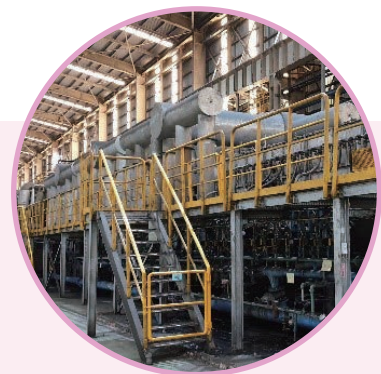
退火爐 防墜欄杆
